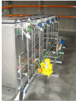
Abb.: Technikseite Versuchsanlage
